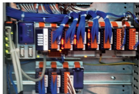
Szafka sterownicza pompowni ze sterownikami Saia®PCD3
