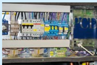
Szafa wentylacyjna sterowana za pomocą PCD1.M2
