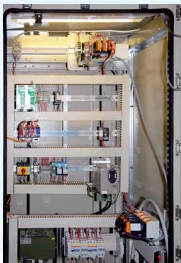
Szafy sterownicze po modernizacji
