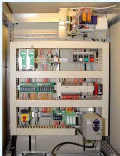
Szafy sterownicze przed modernizacją
