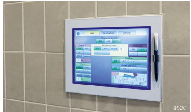
Sterowanie oświetleniem z poziomu panelu dotykowego (Saia PCD7.D412DTPF), szpital Triemli, Zurich
